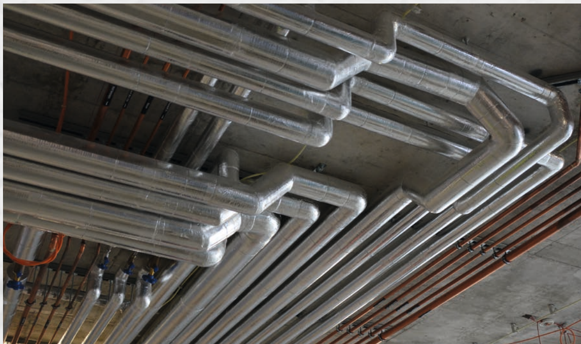
Hôpital Winterthur – Installations sanitaires eau chaude-froide isolées avec swissporKISODUR PIR Alu renforcé
