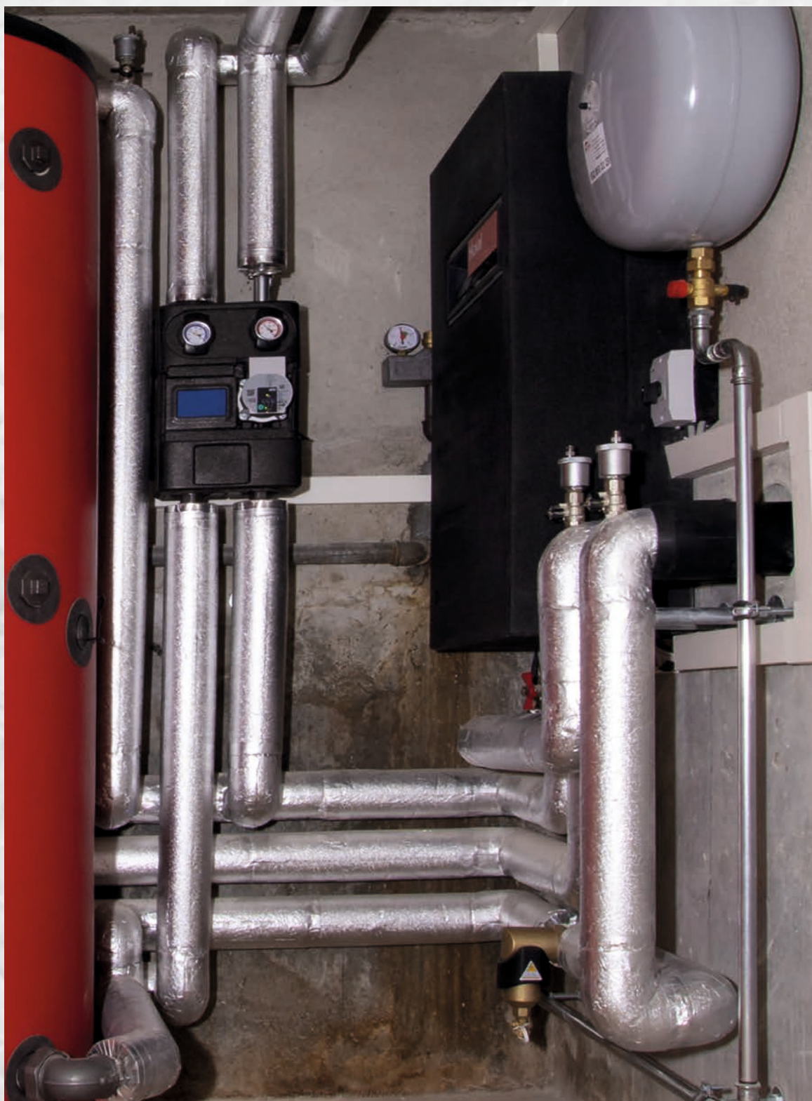
Chaufferie privée à Neuchâtel – Installations de chauffage et sanitaire isolées avec swissporKISODUR PIR Alu écroui
